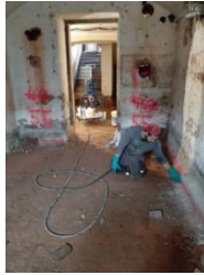
BU: Die alten Klostermauern werden von innen sicher gegen aufsteigende Feuchtigkeit abgedichtet. (Foto: Getifix GmbH)
