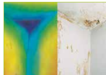
■ Wärmebildaufnahme einer feuchten Ecke
