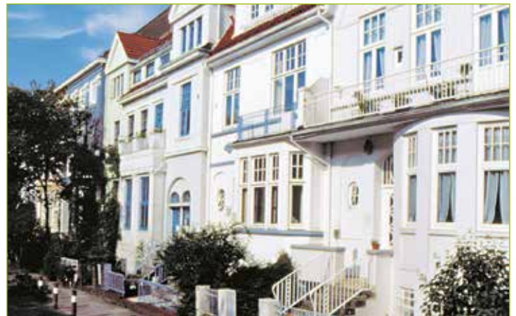
■ Jedes dritte Gebäude in Deutschland hat mit Schimmelpilz zu kämpfen
