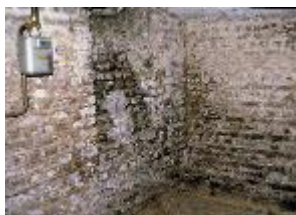
BU: Nicht immer ist klar, auf welchen Wegen die Feuchtigkeit ins Gebäude gelangt. Hier ist eine genaue Analyse notwendig, damit nicht am Schaden vorbei saniert wird (Foto: Getifix GmbH)
