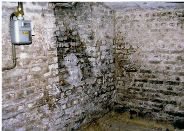
BU: So sehen Keller häufig aus: feucht, an den Wänden Schimmelpilz oder Hausschwamm. In diesem Zustand können die Räume nicht genutzt werden. Weiteres Problem: die Bausubstanz wird nachhaltig geschädigt.
